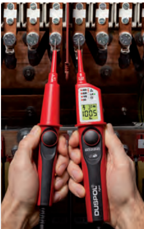
Prüfung von 1000 V AC-Spannung in einer industriellen Stromverteilung
