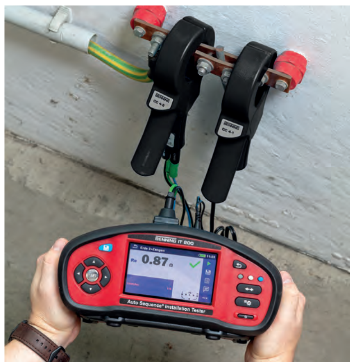
Spießlose Erdschleifenwiderstandsmessung eines Anlagenerders (2-Zangen-Methode) (BENNING IT 200 (044106) mit den optionalen Stromzangenadaptern BENNING CC 4-1 (044166) und BENNING CC 4-2 (044167))
